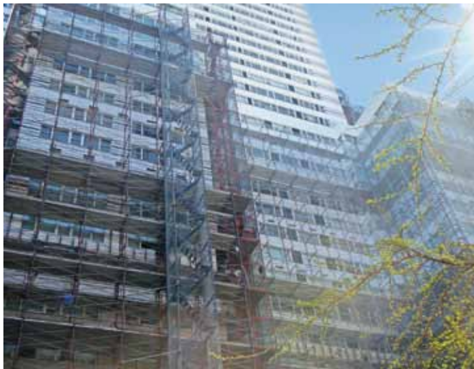
Ein Projektbeispiel für die Instandsetzung der Gebäudehülle ist die Sanierung des Gebäudes 215 East 68 th Street in New York City. Der Eigentümer suchte eine Lösung für eine langfristige Fassadensanierung, die auch die Energieeffizienz des Gebäudes verbessern sollte.
